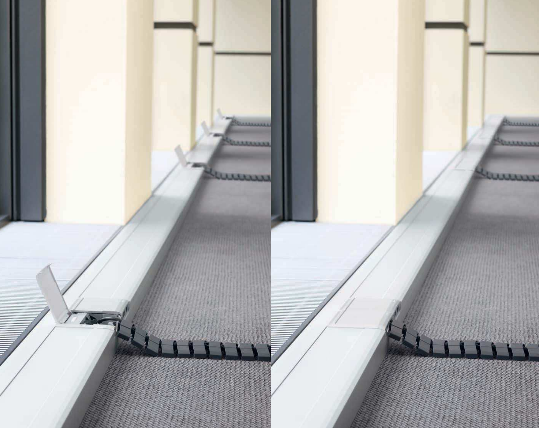
BR netway® aus Aluminium im Bodenbereich installiert mit verdeckten Inline-Einbaugeräten. Leitungsführung zum Schreibtisch mit Flachkette.
